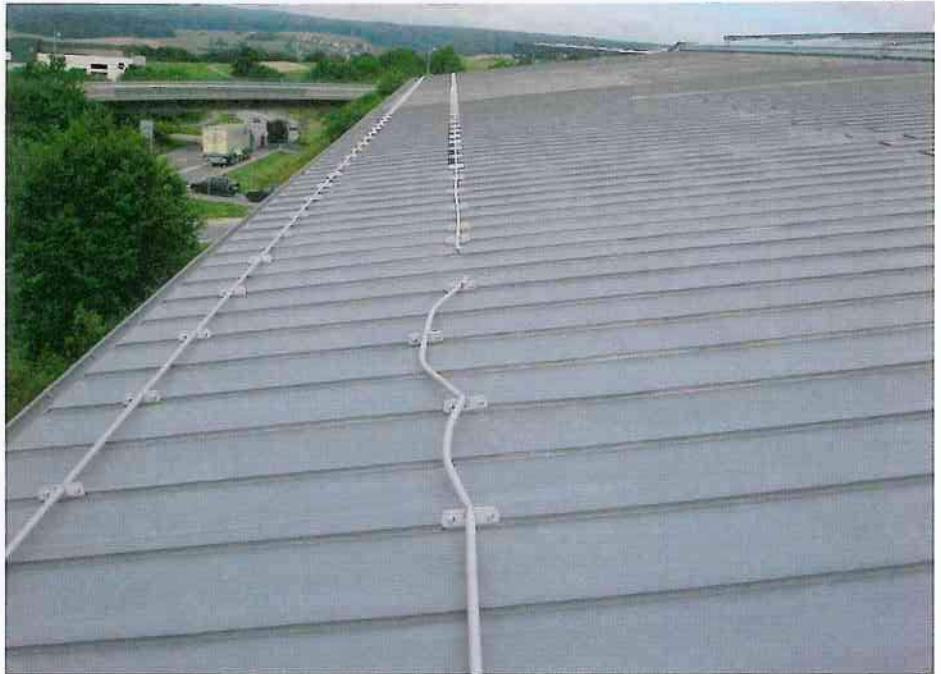
... aber in einer schneereichen Gegend war dieses zu schwach bemessen. Die Schneemassen haben die Rohre verformt und somit konnten die überhängenden Schneebretter die Dachrinne deformieren.
