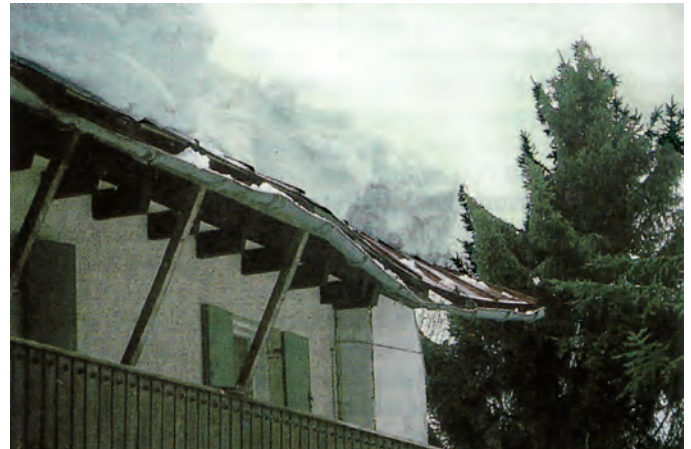
...sind gravierende Schäden die Folge.
