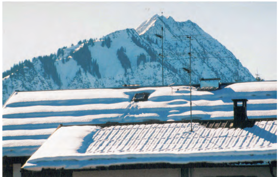
Richtige Anordnung von mehreren Schneefangreihen auf dem Dach. Die Schneelast verteilt sich. Auf dem Dach im Vordergrund ist durch unzureichende Wärmedämmung der Schnee weitgehend abgetaut. Dieses führt zu hohen Eis- und Schneelasten im Traufbereich.
